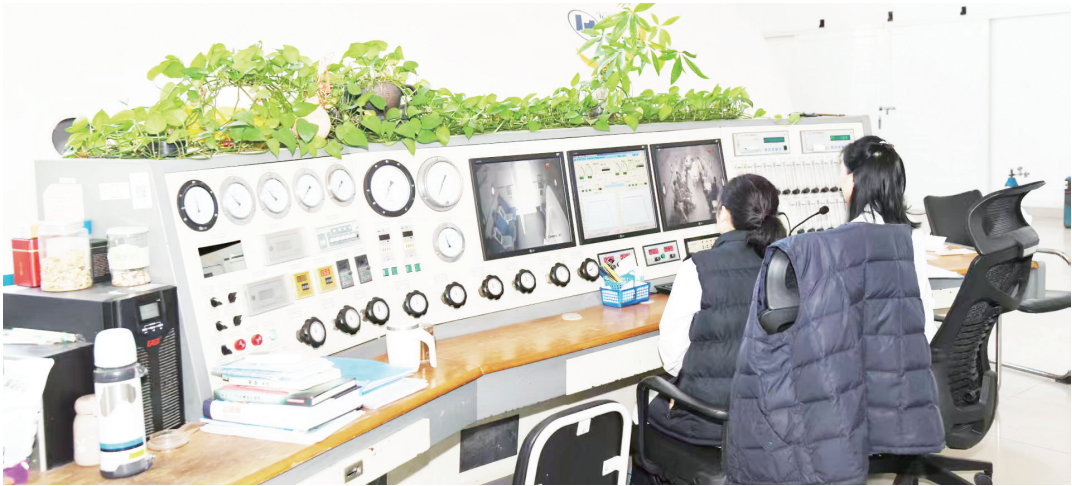
1月21日，在蚌埠医科大学第一附属医院，工作人员正在查看高压氧仓控制系统。张静然 摄
