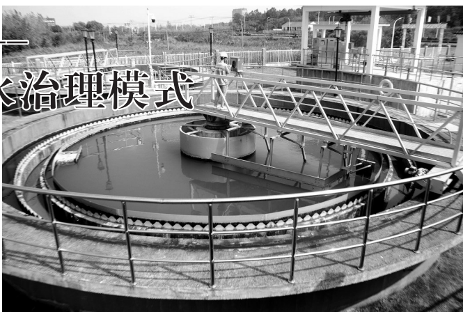
9月29日,含山经开区西区污水处理厂,工人正在查看污水处理运行情况。目前,含山经开区西区、南区和东区三个污水处理厂设计日处理污水2.3万吨,并为林头镇和清溪镇等部分镇村处理生活污水。苏自山 摄
