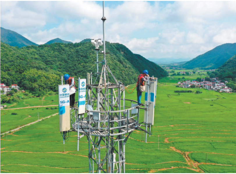
8月12日,铜陵市义安区钟鸣镇泉栏村通信塔上,技术人员在调试设备、升级5G-A网络。 本报通讯员 过仕宁 摄
