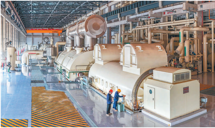
7月1日,淮北矿业下属淮北聚能发电有限公司建设的2×660MW超超临界燃煤发电机组项目二号机组顺利完成168小时满负荷试运行,各项技术指标达标,进入商业运营模式。
