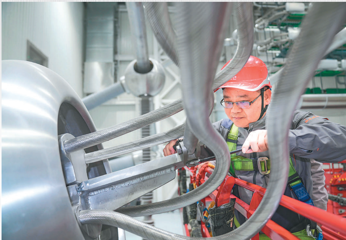
▲ 4月24日,在±800千伏合州换流站板1低端阀厅,王开库检查换流变阀侧套管。
