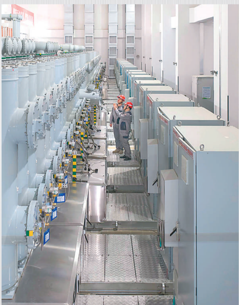
◀ 4月24日,合肥500千伏园博变,王开库(右)和同事检查220千伏户内GIS设备。
