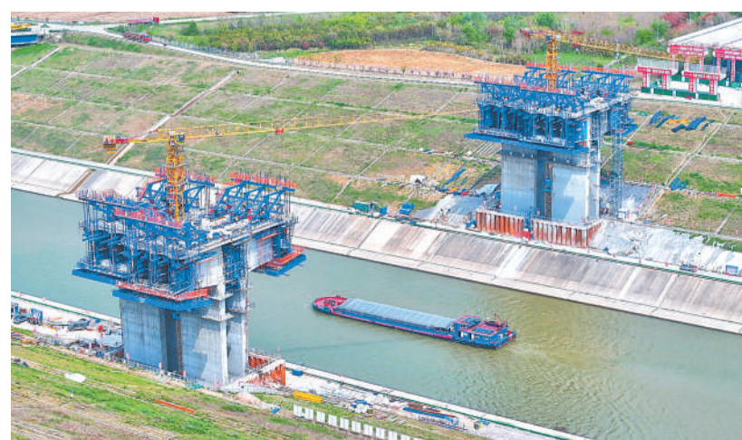
4月8日,在合肥市蜀山区小庙镇,淮桐高速合肥段引江济淮特大桥建设现场,施工人员加紧推进工程建设,确保项目早日建成通车。引江济淮特大桥是淮桐高速合肥段关键控制性工程,全长1078米,跨越引江济淮航道南北大坝。 本报通讯员 陈三虎 摄
