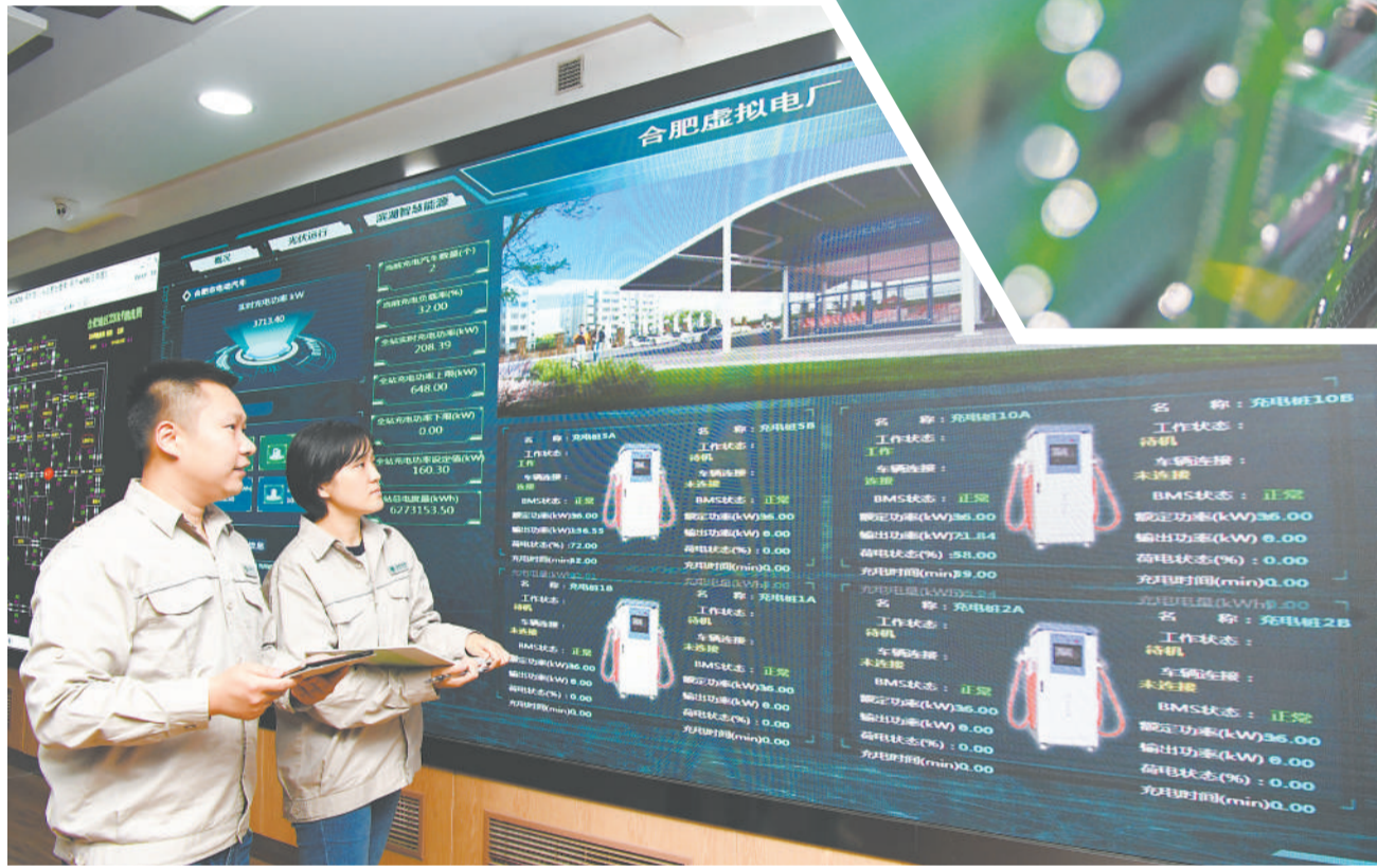
5月20日,在合肥供电公司电力调度控制中心监控大厅,工作人员通过合肥虚拟电厂下发控制指令。总容量达22万千瓦的合肥虚拟电厂系统近日再升级,新加入的“5G+量子”技术全面提升了负荷控制速度和安全性。 本报记者 徐旻昊 本报通讯员 李岩 摄
