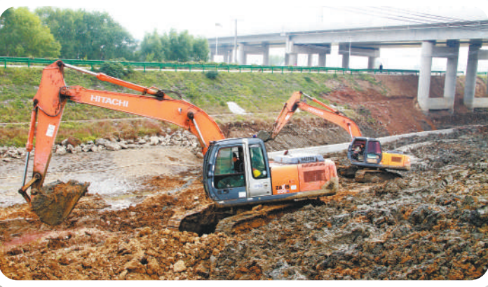
▲ 10月31日,巢湖市夏阁镇组织挖掘机对夏阁河河道进行清淤。当地抓住当前秋季枯水期,掀起秋修水利热潮。 本报通讯员 李廷和 摄
