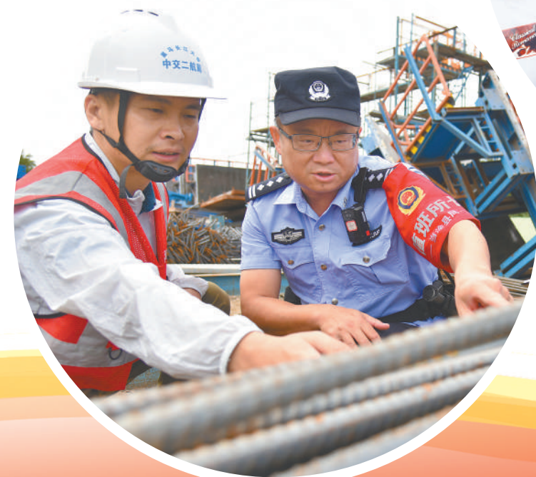
9月20日,当涂县公安局江心派出所民警走进巢马铁路马鞍山长江公铁两用大桥施工现场,开展安全检查和法治宣传,助力企业发展。 本报通讯员 卫学超 摄
