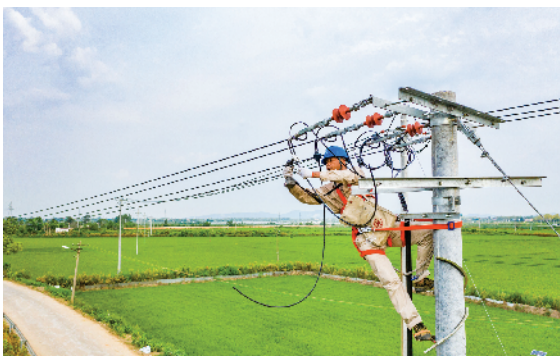
国网庐江县供电公司工作人员进行线路架线施工作业。 丁文康 摄
