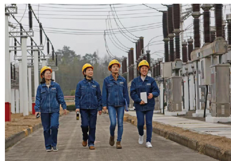
国网安徽省电力有限公司池州供电公司运维值班长陆娟与班组人员进行设备巡视。
