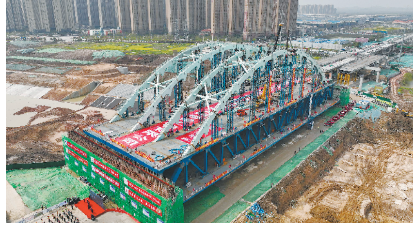
3月27日,引江济淮工程(江淮沟通段)大型市桥桥梁——繁华大道桥主桥拱肋顺利合龙。该桥为我省首座公铁合建双层钢桁架特大拱桥,预计年底将完工通车。 本报记者 李博 摄
