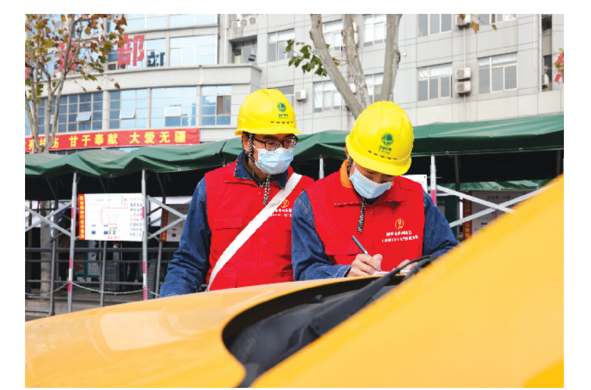
12月16日,在宿州市第一人民医院,宿州供电公司员工对医院核酸检测点的供电设备进行巡视检查,确保疫情期间医院等重点部位用电万无一失。 方圣 摄
