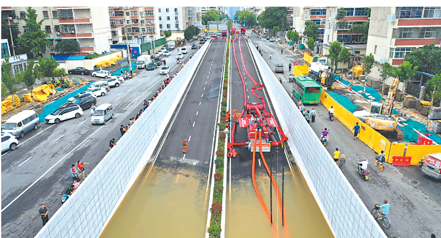
7月21日在郑州市桐柏路附近拍摄的排涝现场(无人机照片)。
