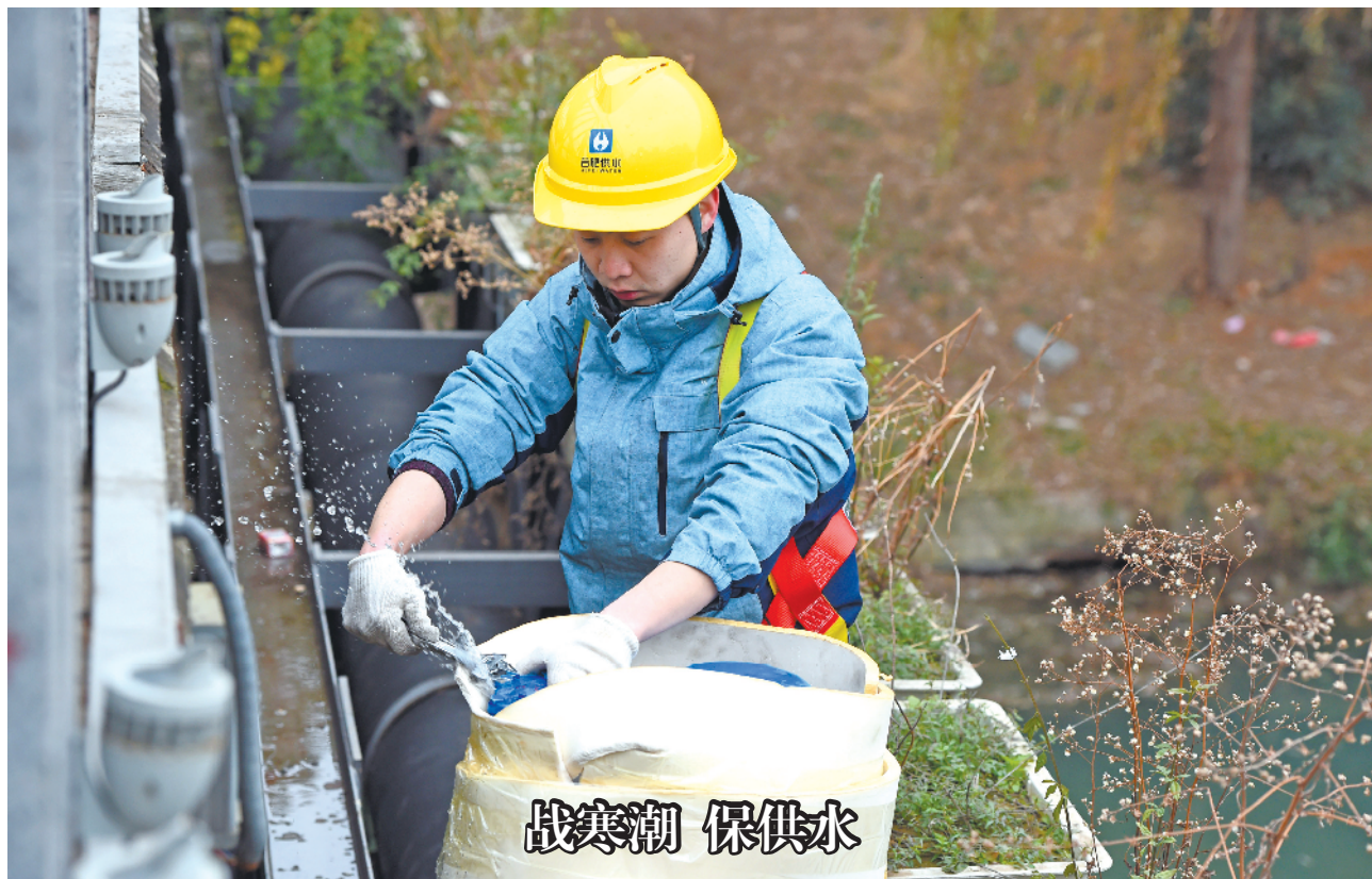
1月6日,在合肥市蜀山区翡翠路辉煌楼,合肥市供水集团的管网服务员在维修漏水的供水设施。当日,合肥市迎来寒潮降温天气,合肥市供水集团的工作人员对全市范围内的供水设施开展检查和维修,重点做好户外供水设施和老旧小区户外水表的维修和保温工作,保障严寒天气下供水安全。 新华社记者 周牧 摄
